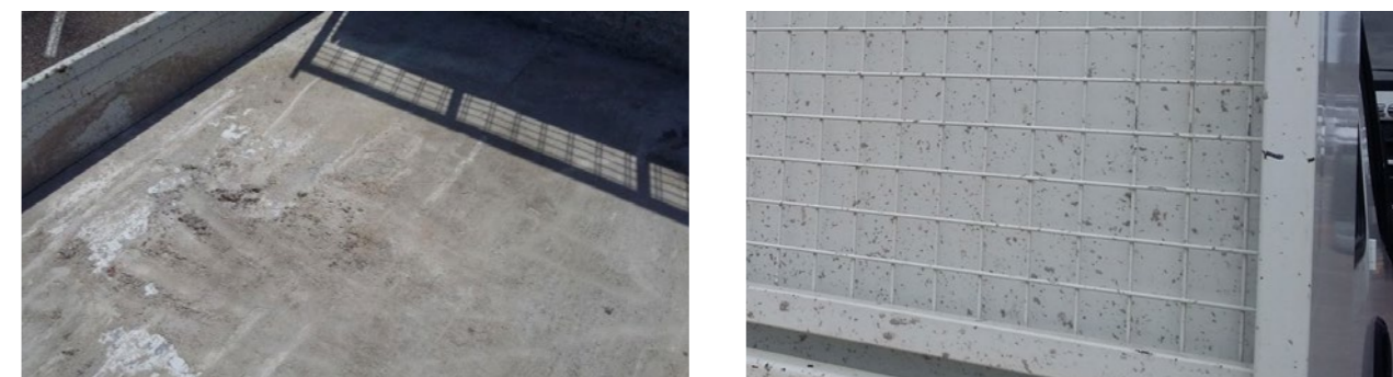
Tragovi betona ili kemijskih proizvoda prekrivaju \geq 1/4 površine kiperu
