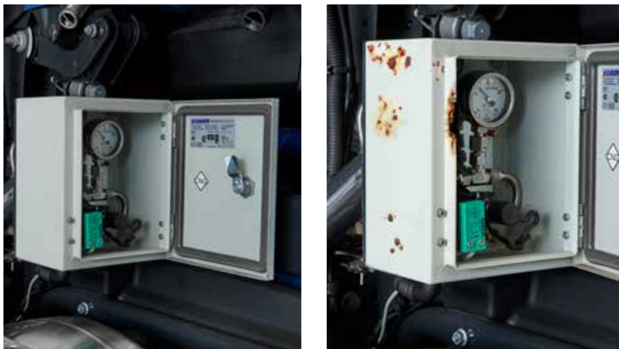
Hrđa na zaštitnom kućištu poklopca za punjenje → bilješka bez naknade za oštećenje.
